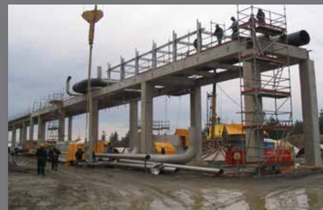
Pipe Rack Perú
