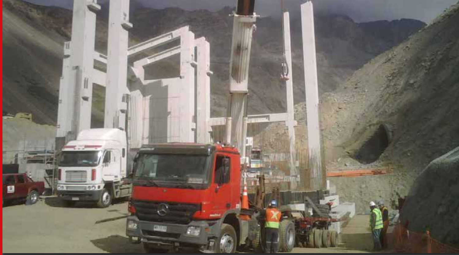
Subestación Andina Codelco
