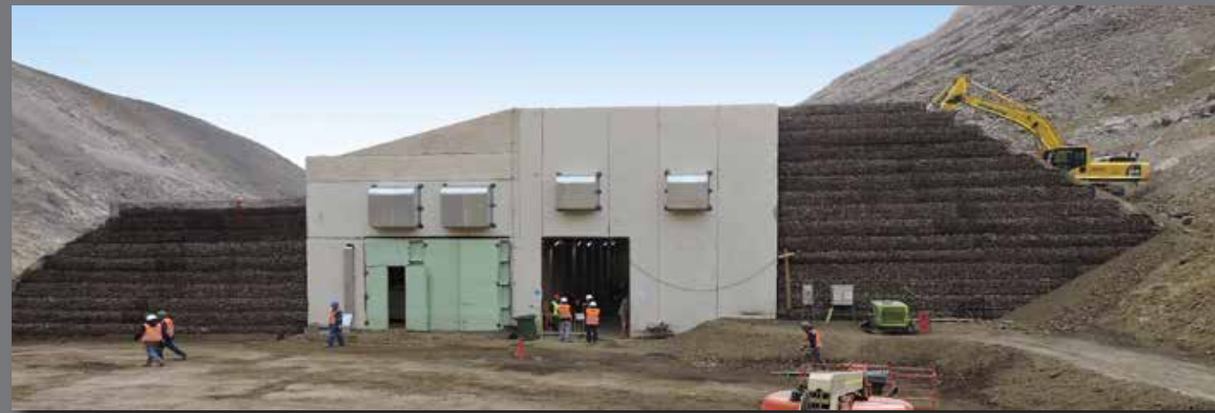
Sala de Bombas los Bronces
