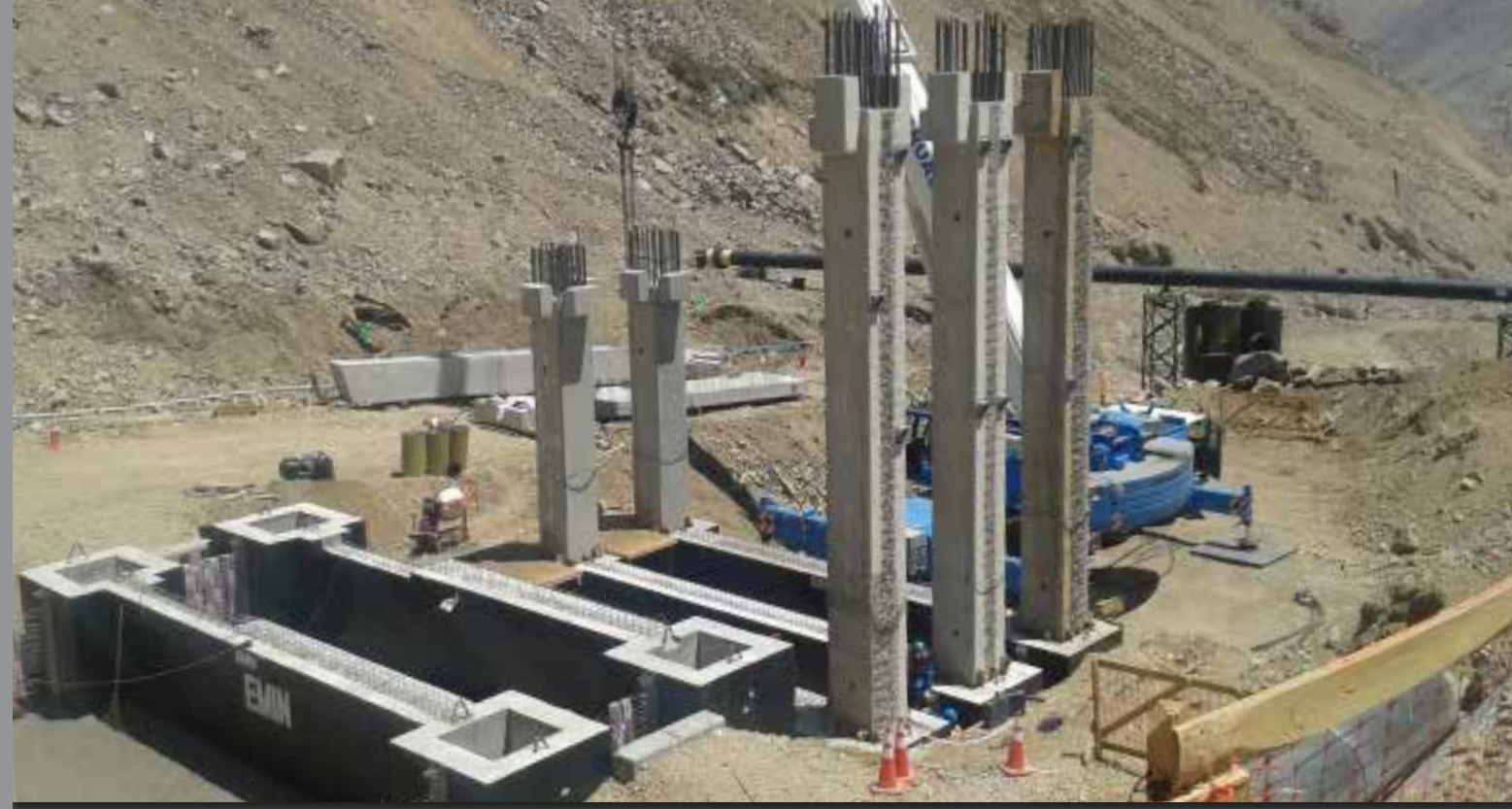
Subestación Andina Codelco
