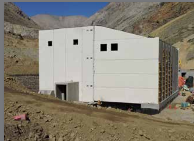
Sala Bombeo Riecillo
